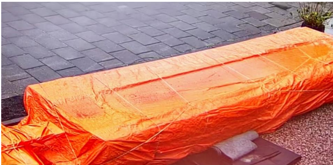
Een voorbeeld van een verkeerde manier van houtopslag. Het zeil zorgt voor een gebrek aan ventilatie.
