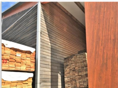
Voorbeeld van een ongelijk vergrijsde gevel.
